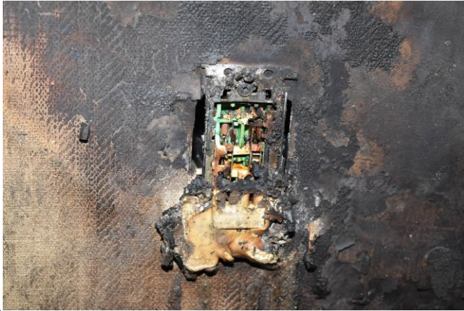
トラッキング現象による出火
