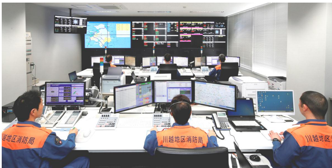
◆ 消防指令センター
